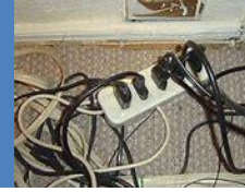
Figura 16. Riesgos eléctricos. Fuente: Google académico. Imágenes.
